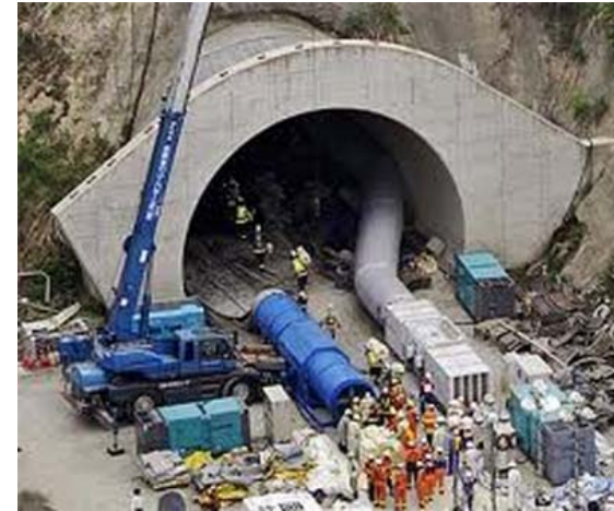
トンネル内で可燃性天然ガスが発生
