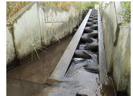
図 農業農村整備事業で設置した魚道
