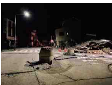
下水道マンホールの損傷
