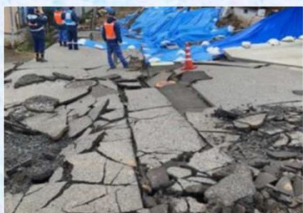
水道管の被災状況
