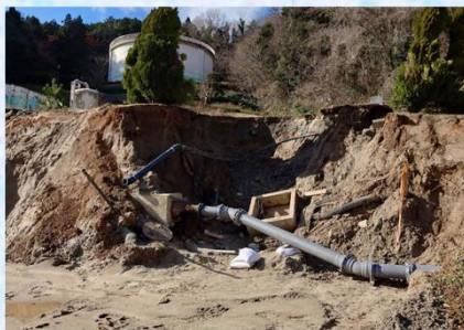
浄水場の場内配管の被災状況
