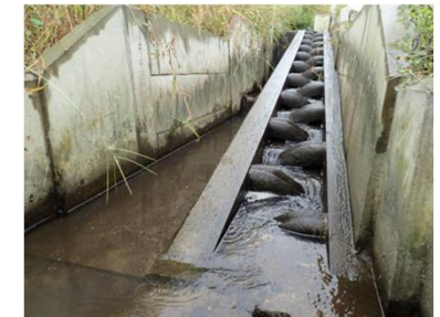
図 農業農村整備事業で設置した魚道
