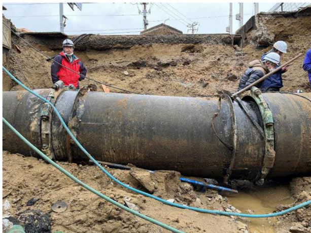
送水管の被害（七尾市）
