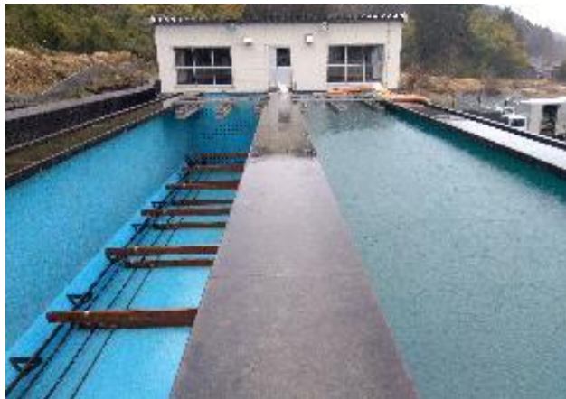
浄水場の被害（珠洲市）
