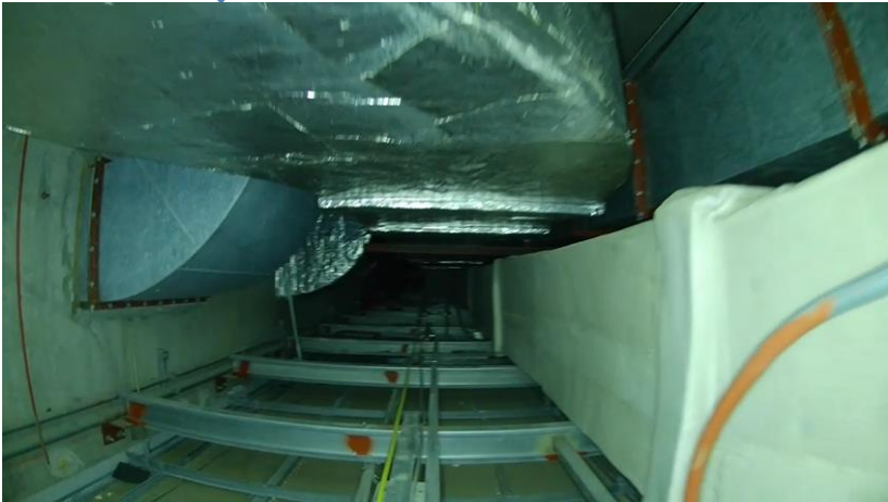
マイクロドローンで撮影した天井裏の壁面漏水状況
